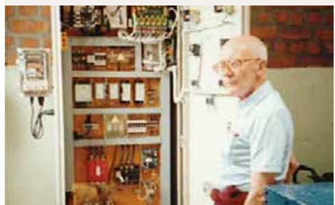
M.G. accanto ad un quadro elettrico.
